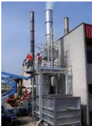
DEPURAZIONE EFFLUENTI DA FORNO ROTANTE SETTORE CONCIARIO (recupero di sali)
