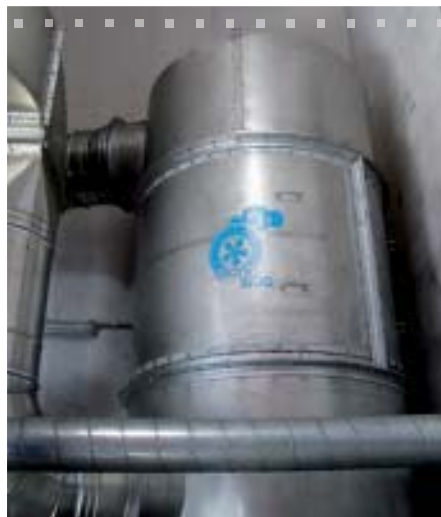
DEPURAZIONE FUMI DA CALDAIA ALIMENTATA CON PULA DI MAIS
