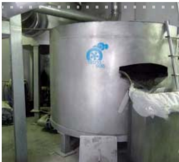
SCARICO DEI FANGHI DALLA VASCA DI RICIRCOLO DOTATA DI FILTRO SEPARATORE
