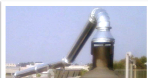
Particolare del collegamento all'esistente sistema di abbattimento che permette anche la raccolta dell'olio per lo smaltimento.
