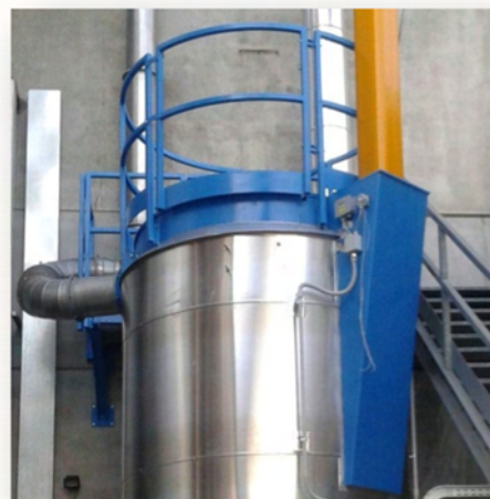
Figura 1: particolare ringhiera protezione
